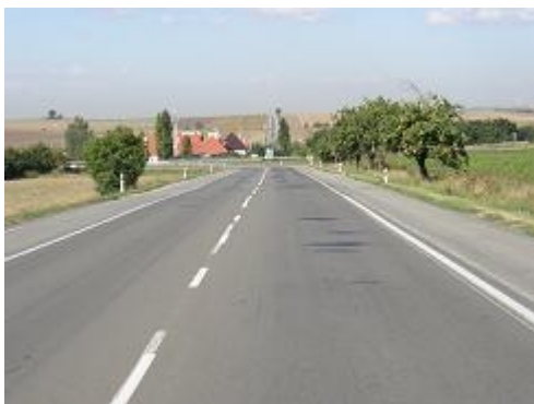
Obr. 10: Nedostatečně označená nebezpečná zatačka (II/430 Vyškov-Brno)
